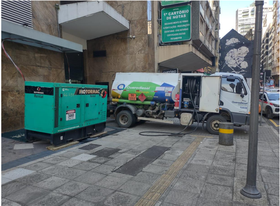
Foto 4.2.1 – Abastecimento do gerador posicionado à frente da portaria do BADESUL.
