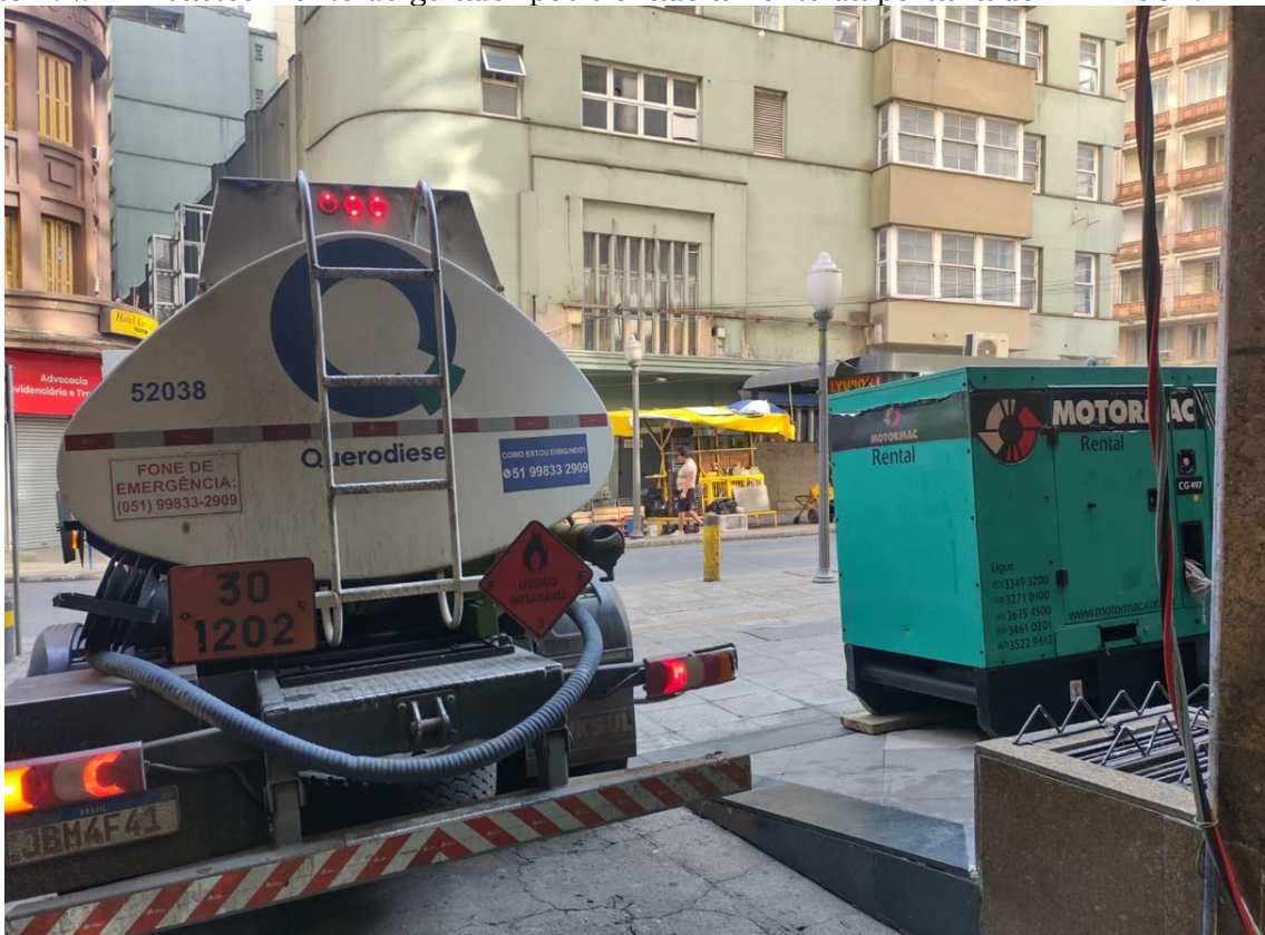
Foto 4.2.2 – Abastecimento do gerador posicionado à frente da portaria do BADESUL.
