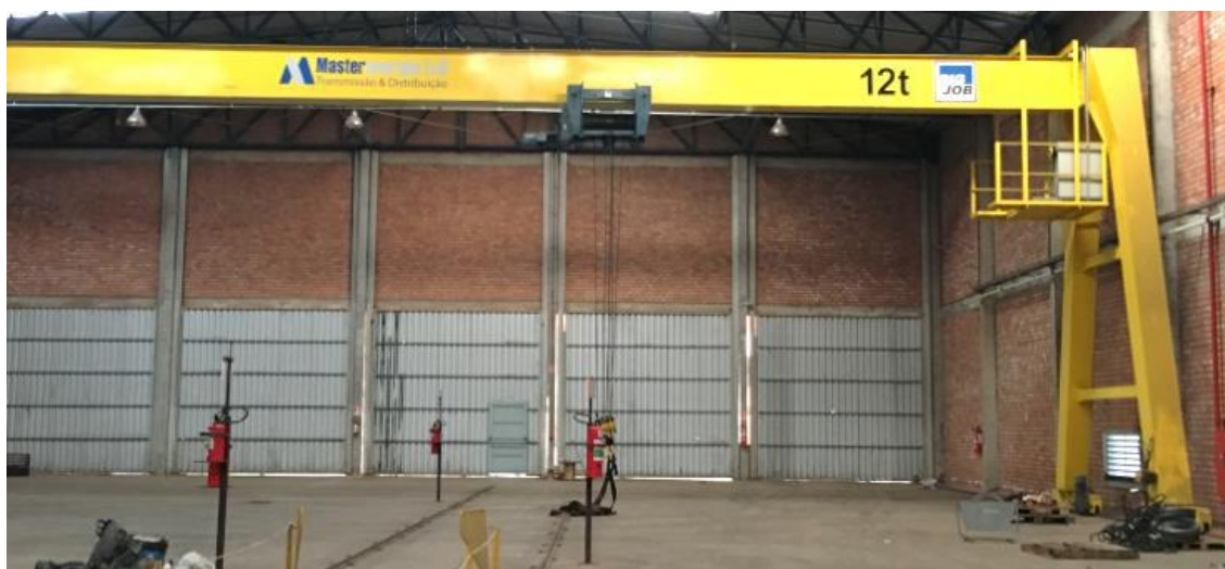
Figura 4: Ponte rolante 12,00 t x 27,00m.
